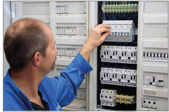
Bild 1: Verteilerschrank einer Elektroinstallation mit Schutzschaltern www.siemens.com
